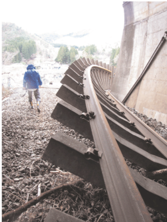
跳ね上がった線路（この先の鉄橋は橋げたと共に流されていた。釜石市）。
